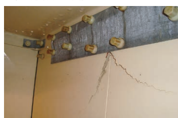
仕切板が破損しているもの
