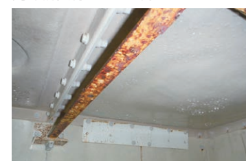
内部補強材が著しく腐食しているもの
